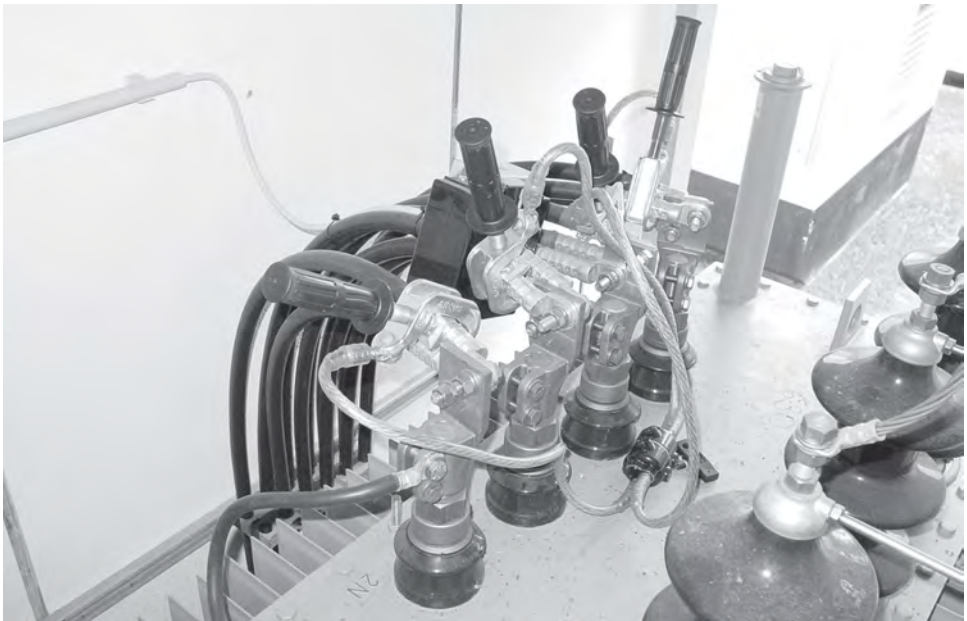
Erdungs- und Kurzschließvorrichtung im Einsatz auf der Niederspannungsseite eines Transformators
